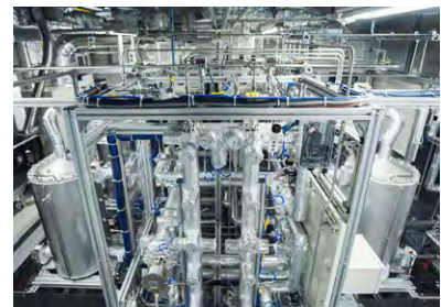
CO 2 循環プラント内の設備
