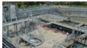
排水処理施設(善明製作所)
