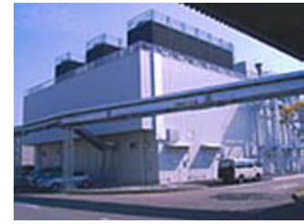
大安製作所 コージェネレーション設備
